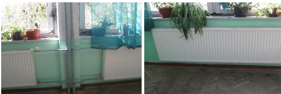
Slika 16. Prikaz radijatora instaliranih u učionicama
