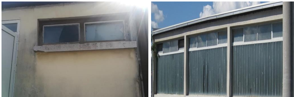
Slika 11. Prozori na dvorani i njihova oštećenja
