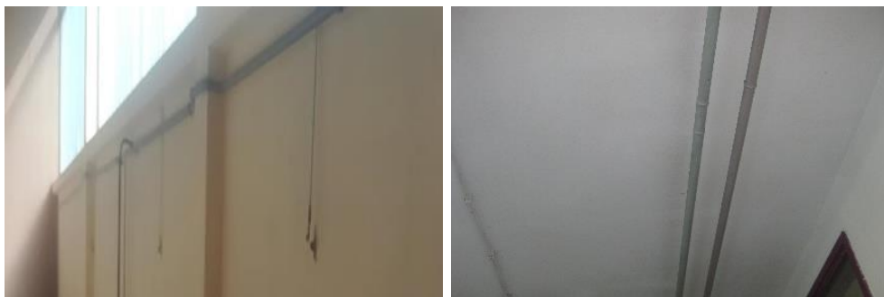
Slika 21. Horizontalni dio cjevovoda (lijevo) i cjevovod kroz dvoranu (desno)
