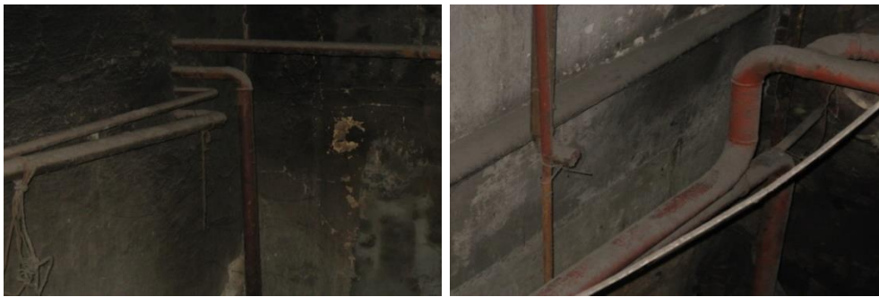
Slika 20. Prikaz neizolovanog cjevovoda
