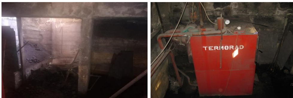
Slika 23. Pogled na dio skladišta uglja (lijevo) i kotao (desno)
