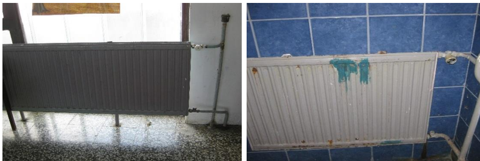
Slika 17. Prikaz radijatora montiranih pored staklenih površina (lijevo) i u prostoru sanitarija (desno)
