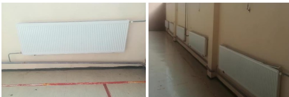
Slika 18. Prikaz radijatora u prostoru dvorane
