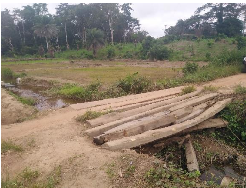
Pont en bois non stables sur la route de vetouo
