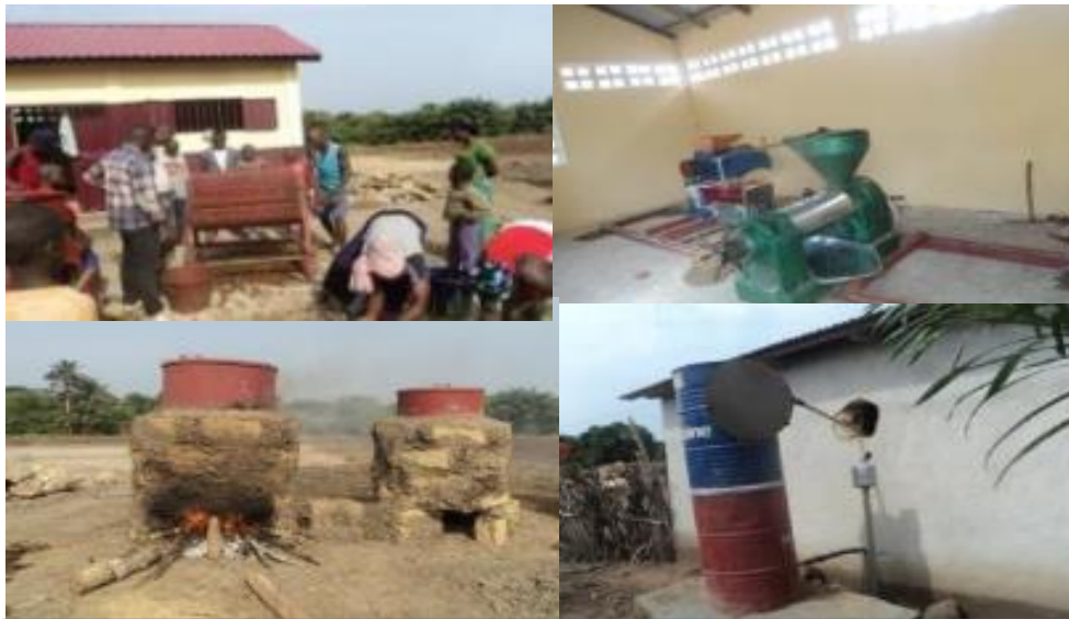
Plateforme multifonctionnelle achetée, installée et fonctionnelle
