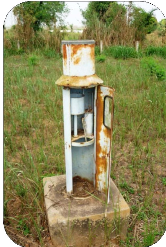
Figure 7.1 : Pluviomètre en panne
